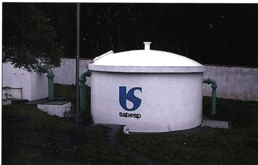
Foto 12 - Reservatório apoiado RA01 - Colômbia
