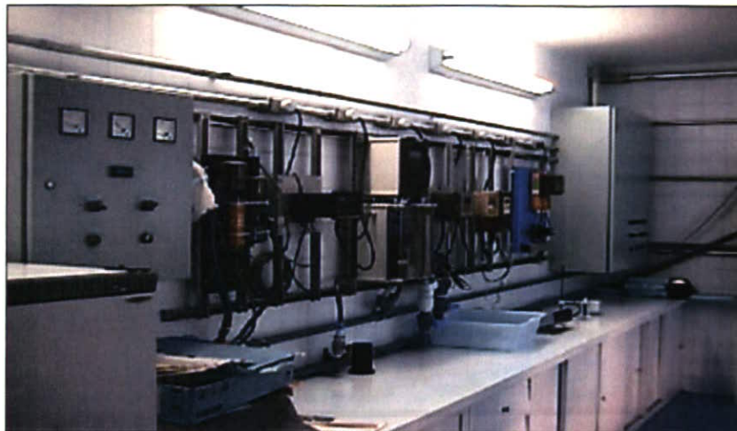
Foto 11 - Sistema automático de dosagem de produtos químicos
