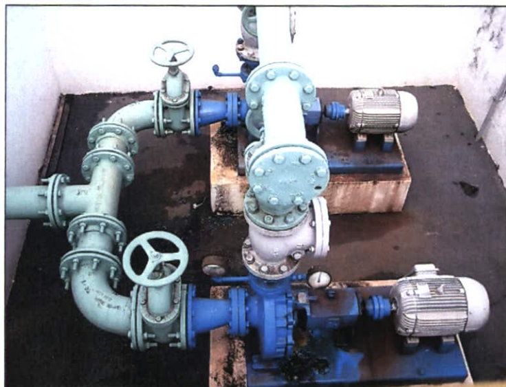
Foto 17 - Estação elevatória de água tratada EEAT02 - Colômbia
