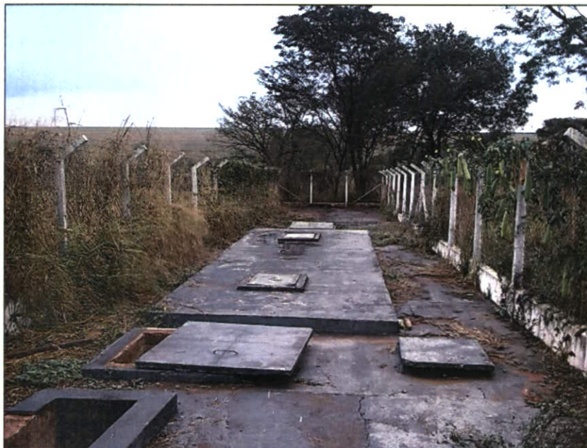
Foto 23 - Fossa Filtro - Laranjeiras
