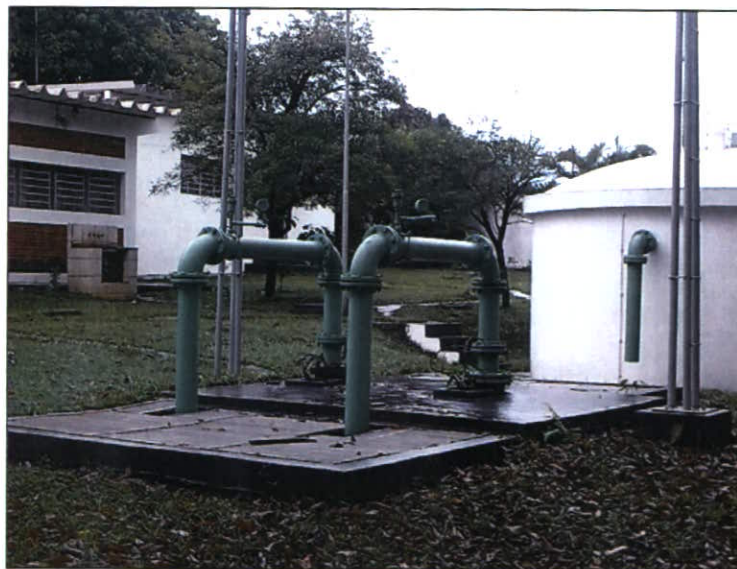
Foto 16 - Estação elevatória de água tratada EEAT01 - Colômbia
