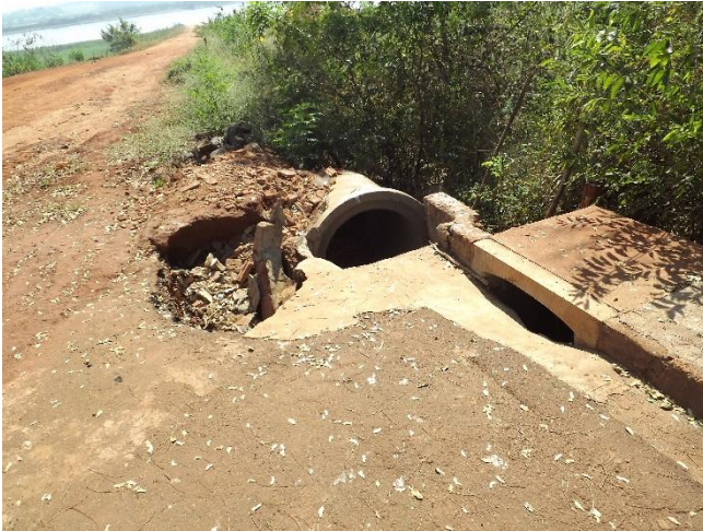
Foto 3.9 – Detalhe de problemas estruturais da galeria de águas pluviais no Ponto P4
