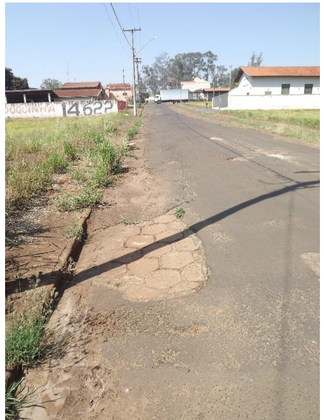
Foto 3.4 – Detalhe de problemas no pavimento asfáltico em ponto crítico
