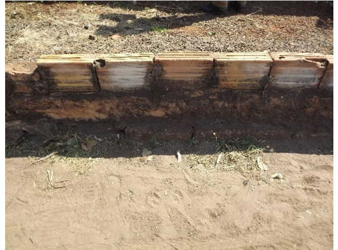
Foto 3.2 – Detalhe do alteamento de guia como medida paliativa aos efeitos negativos do alagamento no ponto crítico
