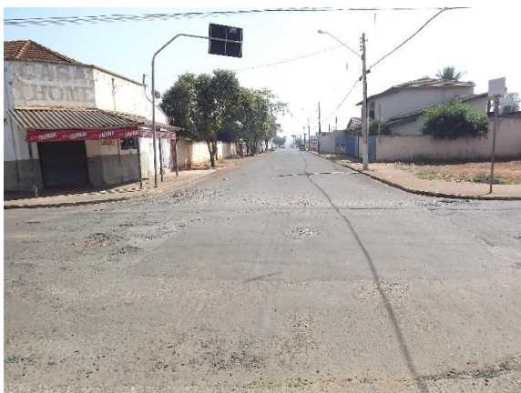
Foto 3.7 – Ponto crítico no cruzamento da Rua José da Mata com a Rua Wenceslau Brás onde há alagamento e danos ao pavimento asfáltico em dias de chuvas intensas
