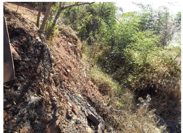
Foto 3.16 – Encosta da Voçoroca
