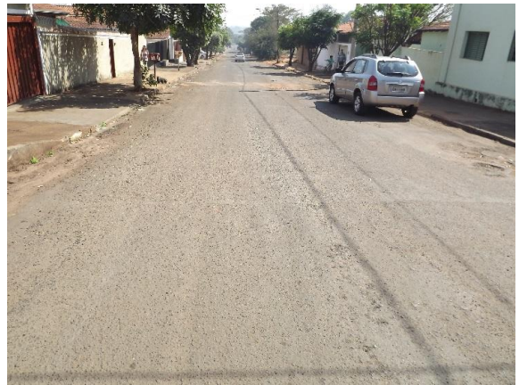
Foto 3.6 – Detalhe de ponto crítico em que há alagamento, no cruzamento da Rua Rio Branco com a Rua Josefino da Rocha Ribeiro
