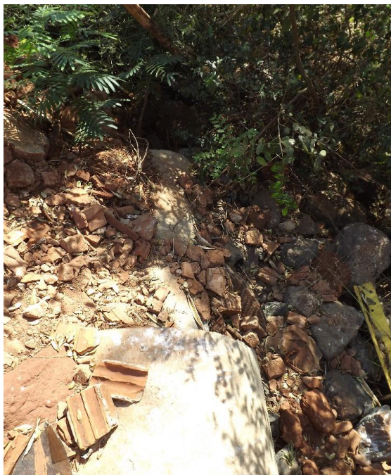
Foto 3.11 – Problemas de erosão superficial decorrente do problema estrutural da galeria de águas pluviais no P4
