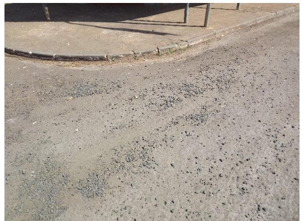
Foto 3.8 – Detalhe de problemas no pavimento asfáltico no ponto crítico P3
