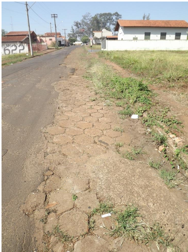
Foto 3.3 – Detalhe de problemas no pavimento asfáltico causados pelo escoamento superficial em alta velocidade em episódios de chuvas intensas
