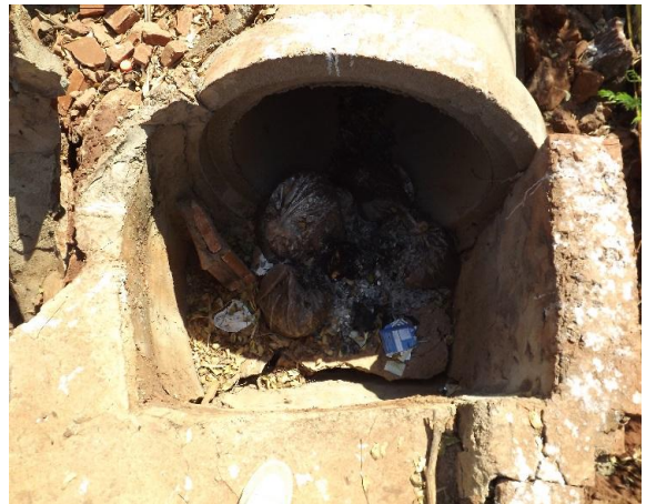
Foto 3.10 – Detalhe do acúmulo de resíduos sólidos no interior da galeria
