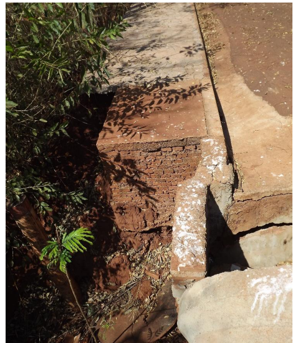
Foto 3.12 – Detalhe de problemas estruturais na galeria de águas pluviais no P4
